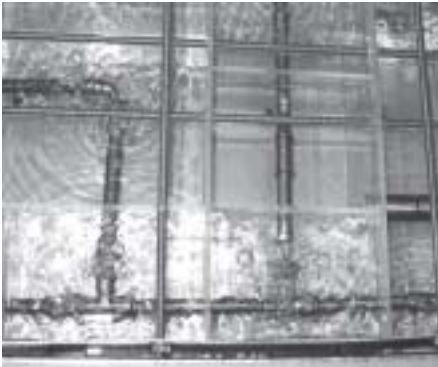
Im laufenden Versuch mit Druckluft sind zwei unverpresste Verbindungen dicht (keine Gasblasen), obwohl sie es nicht sein dürften.
